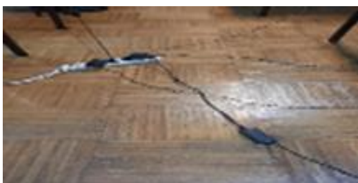
Figura 4. Cabos de alimentação
