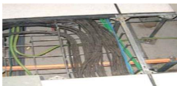
Figura 1. Detecção por aspiração em chão falso
