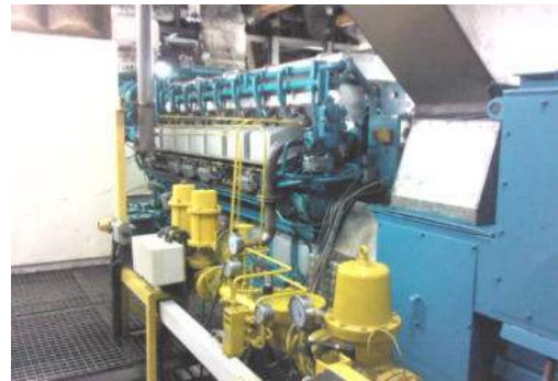
Figura 4 – Motor de combustão instalado no Norteshopping
