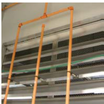
Figura 2. Detecção por aspiração em grelhas de ventilação e bastidores
