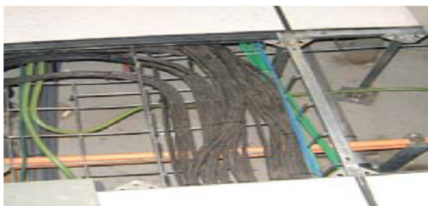
Figura 1. Detecção por aspiração em chão falso
