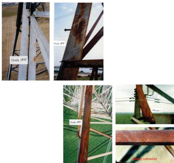
Figura 5. Avaliação dos diferentes níveis de corrosão
